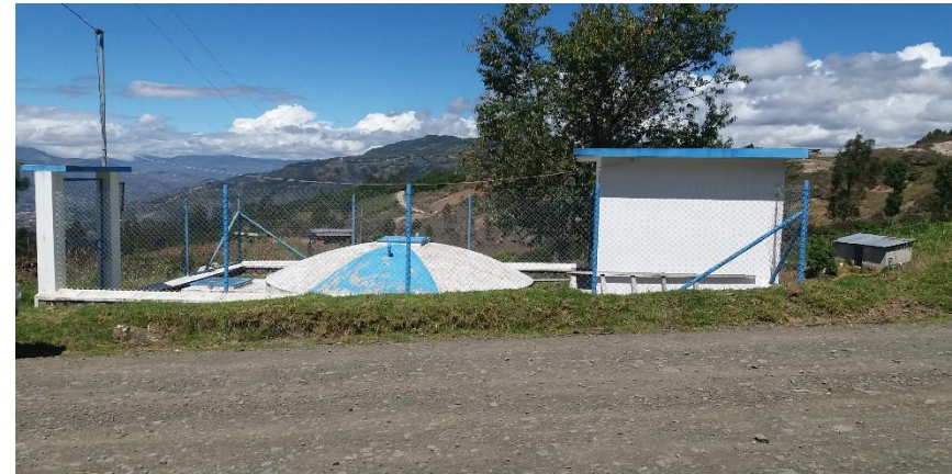
Imagen 10. Planta de Agua Potable
